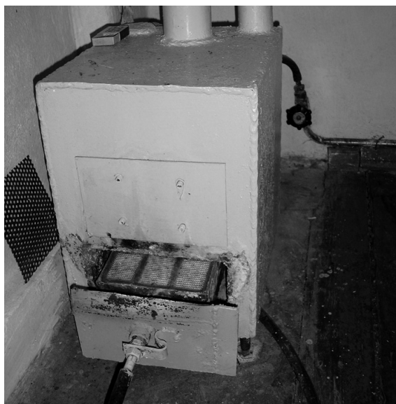
Рис.35. Водонагревательный котел для отопления дома с излучающими керамическими нагревателями в с. Петровка. Фото: Веденев А.Г., ОФ «Флюид»
