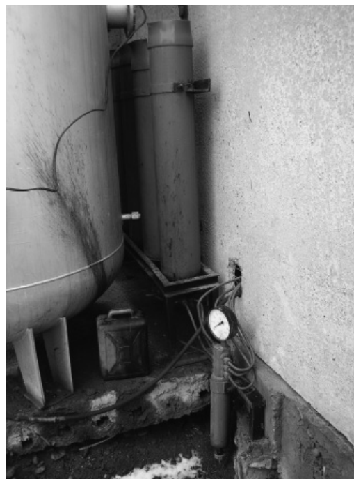
Рис.23б. Стальные газгольдеры высокого давления в с. Петровка. Фото: Веденев А.Г., ОФ «Флюид»
